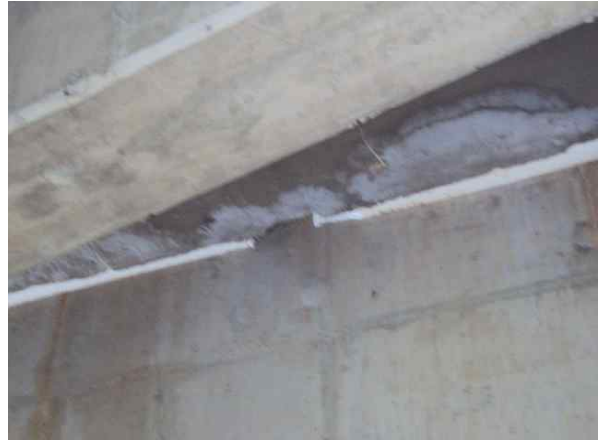
바닥판하면 S1 파손 (0.1×0.2)
